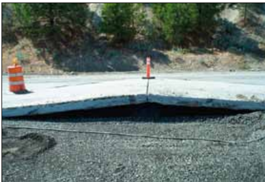
Фото 4. Выпучивание цементобетонного покрытия в шве расширения на дороге в США
