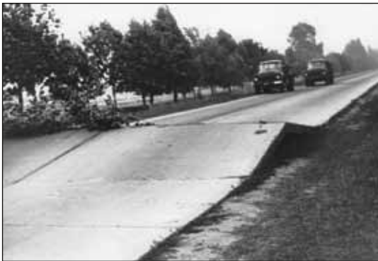
Фото 3. Выпучивание цементобетонного покрытия в шве расширения на дороге Киев—Одесса вблизи г. Белая Церковь (фото И.Е. Духовного): Примерно 6 часов вечера, и уже смеркает. В ДЭУ еще не знают о происшествии. Знаков, ограничивающих скорость, нет. Сотрудники ГосдорНИИ срубили деревцо, чтобы как-то обозначить «трамплин».
