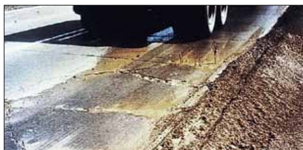
Фото 5. Выплески материала основания из-под цементобетонного покрытия
