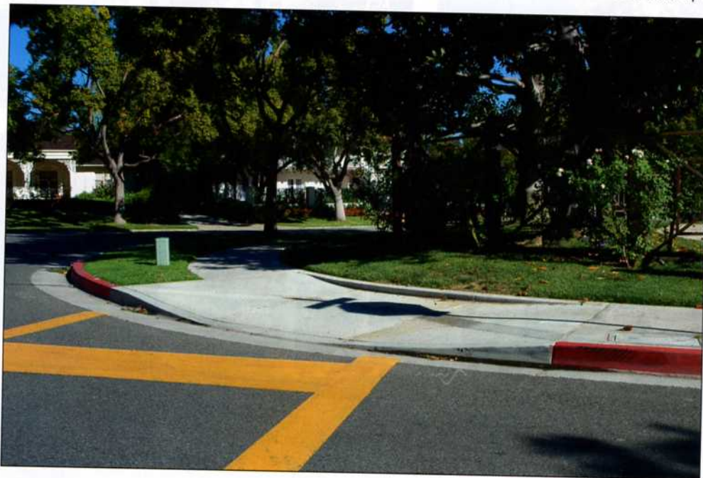
Бортовой камень, объединенный с боковой канавкой, выполняется только в монолитном цементобетоне. В красный цвет окрашен бортовой камень там, где остановка запрещается.
