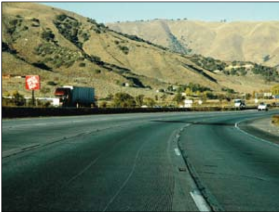
Рис. 8. Продольные бороздки на бетонном покрытии
